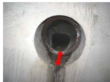
nicht bündig zur Kanalwandung
