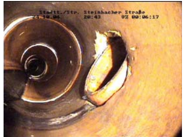
einragend, undichte Rohrführung
