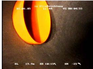
einragend, undichte Rohrführung
