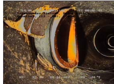
einragend, Zerstörung Hauptkanal
