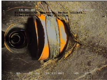
einragend, Zerstörung Hauptkanal
