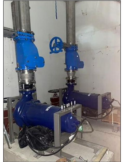
neu aufgestellte Pumpen
