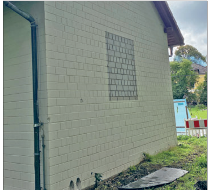
Verschlossene Wanddurchführung (Lüftungsgitter der stationären Netzersatzanlage)
