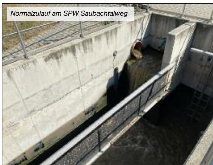
Starker Zulauf von Schmelzwasser am Überleitungspumpwerk unterhalb der Autobahn (SPW Saubachtalweg) am 25.12.2023
