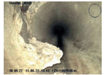
verfestigte Ablagerungen, Mühlweg
