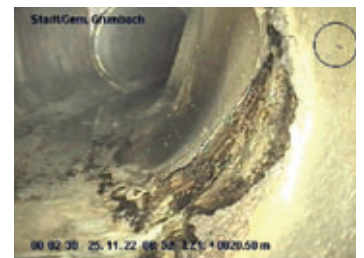
undichte Rohrverbindung, Arthur-Kühne-Straße
