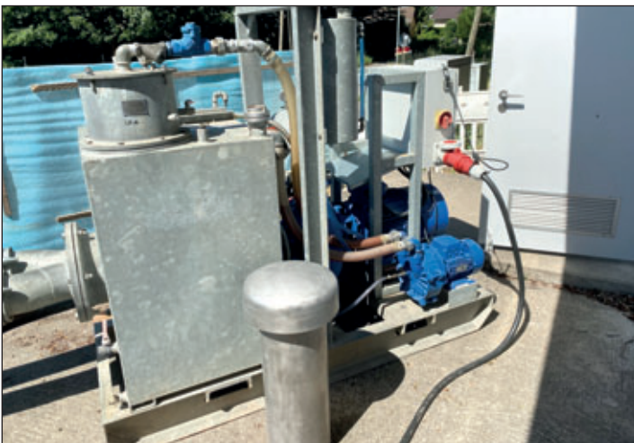
provisorische Pumpanlage am SPW An der Mühle
