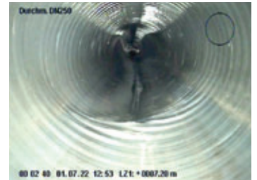
leichte Rohrdeformation, Limbacher Straße
