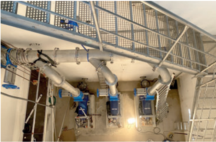
Blick in das neu ausgerüstete SWP An der Mühle
